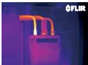
Schlechte Verbindung und innere Beschädigung
