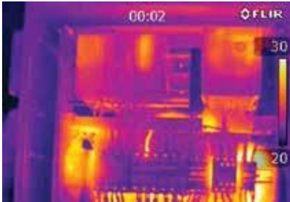
Wärmebildinspektion eines elektrischen Schaltschranks
