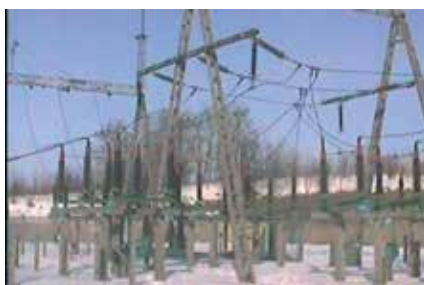
150-kV-Station, Tageslicht- und Wärmebilder
