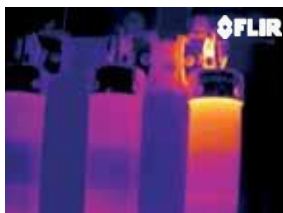
Innere Beschädigung einer Sicherung
