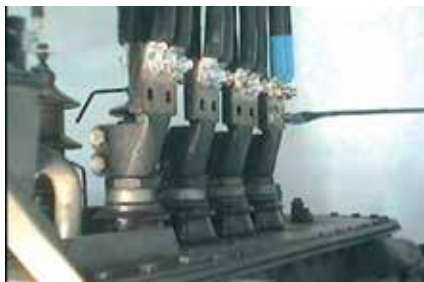
Oberer Teil eines Transformators; Hochspannungs- verbindung
