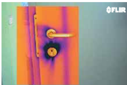
Luftundichtigkeiten in der Tür mit erheblichem Temperaturunterschied
