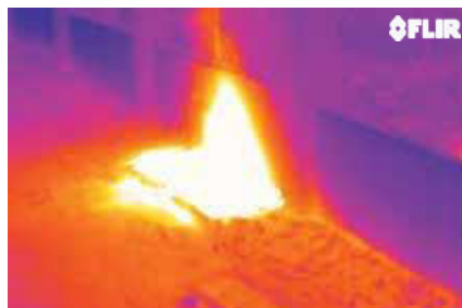
Wärmebilder liefern detaillierte Informationen, die zur exakten Ortung von Leckagen oder Schäden äußerst wertvoll sind.
