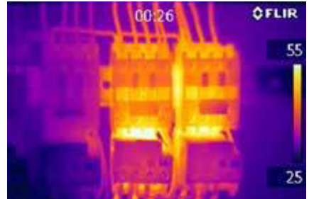
Das Wärmebild zeigt eindeutig, welche Sicherungen zu warm sind und demnächst ersetzt werden müssen.
