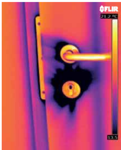
Luftundichtigkeit am Türbeschlag ist deutlich zu erkennen.
