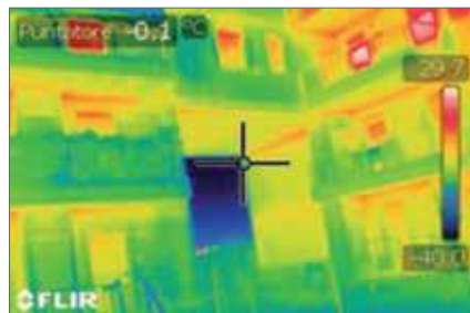
Dieses Wärmebild zeigt eindeutig die Wärmeverluste am Gebäude.
