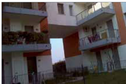
Tageslichtbild der Wärmeverluste am Gebäude
