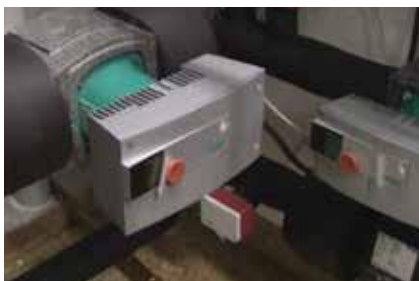
Wärme- und Tageslichtbild einer elektrischen Wasserpumpe.
